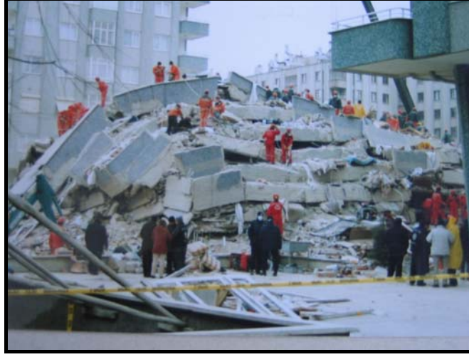
Şekil 3. Betonarme karkas yapıda malzeme, tasarım, uygulama hataları sonucu yıkılan sekiz katlı yapı görünüşü .
