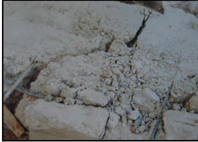
Şekil 2. Beton karışımı içine giren malzemelerden agrega oranının ve donatının uygun olmadığı, sonuçta betonun yeterli mukavemeti sağlamadığı anlaşılmıştır.
