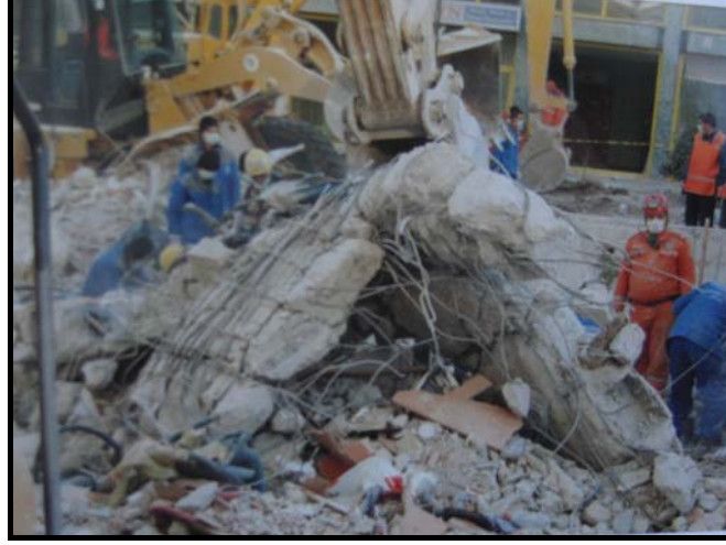
Şekil 1. Deprem etkisine maruz kalmadan, kendiliğinden yıkılmış karkas bir yapının beton malzemesinden görünüşü.
