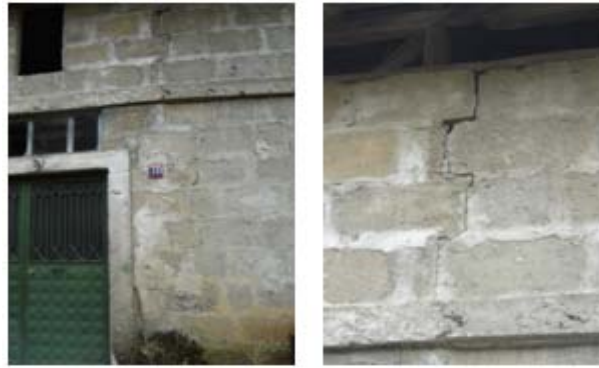
Şekil-6. Yığma binanın yan duvarlarında gözlemlenen hasarlar.
