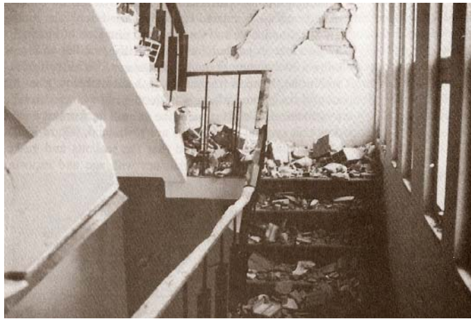
Şekil-19. Deprem sonrasında merdiven sahanlığı ve kaçış yollarının kopan malzeme parçaları ile kapanması (FEMA 149)
