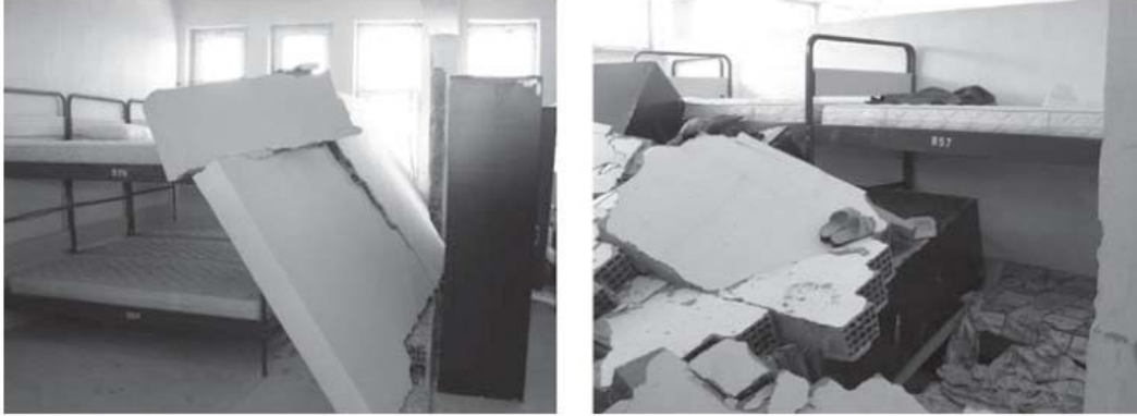
Şekil-16. İki yatakhane arasında yer alan dolgu duvarın yıkılması (Gülkan, 2004)
