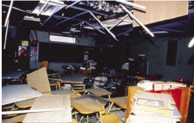
Şekil-17. Sınıf mekanında asma tavan sisteminin taşıyıcı sisteme doğru bağlanmamasına bağlı olarak yıkılması, Northridge, CA, 1994 (FEMA 424 – Kaynak: Gary McGavin, Redlands, CA)
